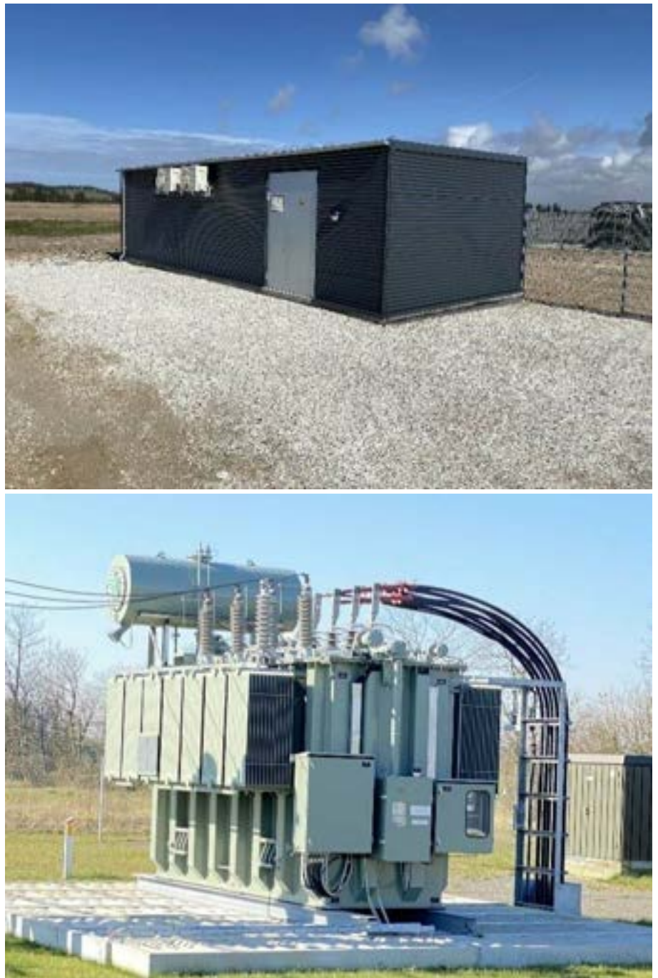
Figur 9. Eksempel på Stationshus og Forsyningstransformer
